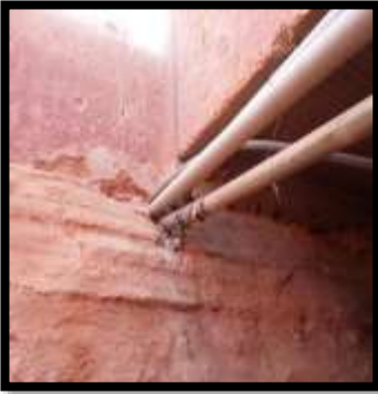
الصورة رقم(21): تصريف المياه
